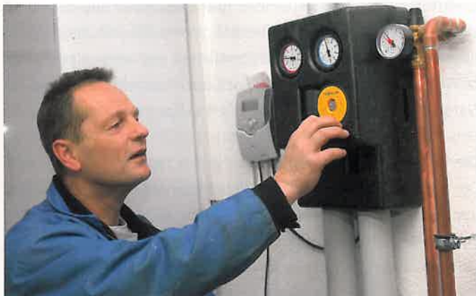
Hat die Anlage in seiner Freizeit geplant, installiert und optimal eingestellt: Vereinsmitglied und Heizungsbau-Meister Eugen Unkelbach
