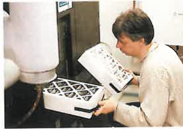
Etwa alle 90 Tage wird der Staubfilter der Lüftungsanlage gewechselt – für Allergiker ein Segen. Die Innenluft bleibt trotz geschlossener Fenster frisch und die Pollen sperrt man aus
