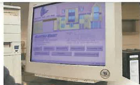
Vom Keller aus steuert ein zentraler Rechner alle technischen Anlagen im Haus
