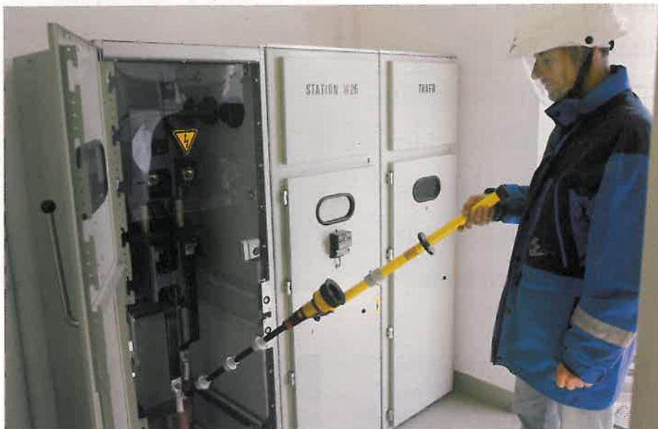
Fehlersuche: Fällt der Strom aus, prüfen die Techniker des EZV ihre Anlagen, um die Stelle, an der der Fehler aufgetreten ist, zu isolieren, vom Netz zu trennen und den Strom von der anderen Seite her zuzuschalten
