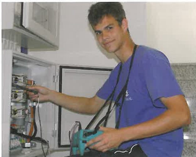
Christoph Hein arbeitet seit Mitte Februar als Elektroniker für Betriebstechnik beim EZV.
