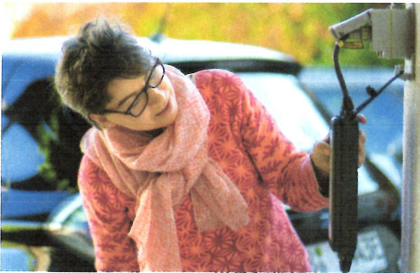
Es muss nicht zwangsläufig eine Wallbox sein: Vor allem bei Zweitwagen leistet das mit dem Fahrzeug gelieferte Ladegerät in Verbindung mit einer ausreichend abgesicherten Steckdose gute Dienste.
