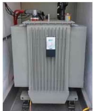
... eine neue Niederspannungshauptverteilung (oben) und einen neuen Transformator. Bei allen drei Komponenten macht die EZV keine Kompromisse in Sachen Qualität. Das gilt natürlich auch für den Einbau durch eigenes Fachpersonal.
